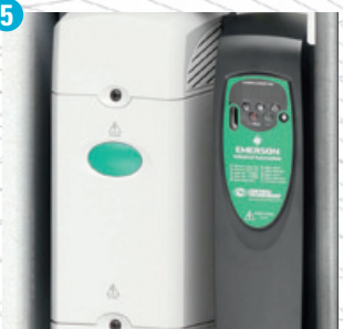
New VSD cubicle
